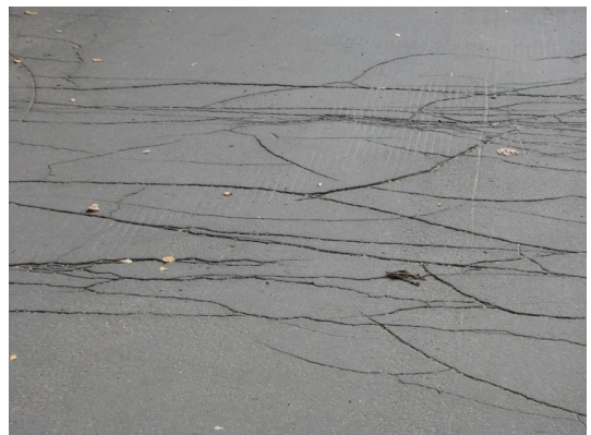
Reittikuva 5. Asfaltin epätasaisuuksia Puistokadulla.
