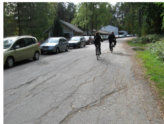
Reittikuva 8. Kankaankadulla ei ole kevytväylää. Katu pitäisi kokonaisuudessaan päällystää uudelleen. Samalla kadulle voitaisiin toteuttaa pyöräkaistat.
