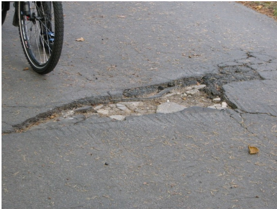
Reittikuva 6. Vaarallinen vaurio asfaltissa Puistokadulla.
