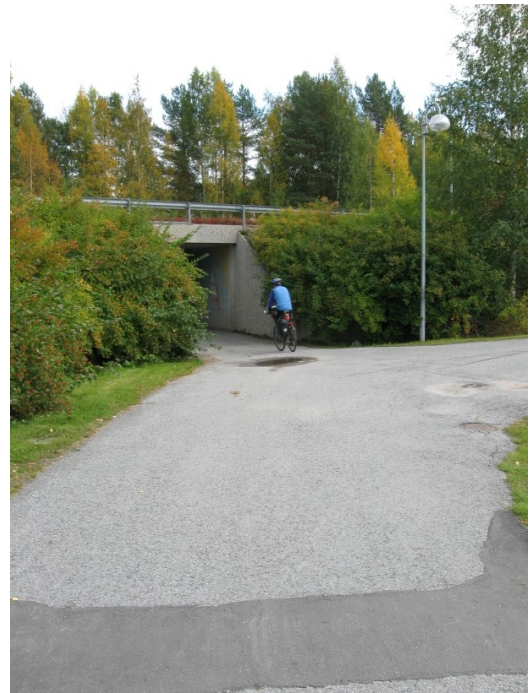
Reittikuva 26. Vaarallinen tunneli Ritopohjantien alitse. Puskat peittävät näkyvyyttä pahasti. Monet Palokan lapset käyttävät tunnelia koulumatkallaan.
