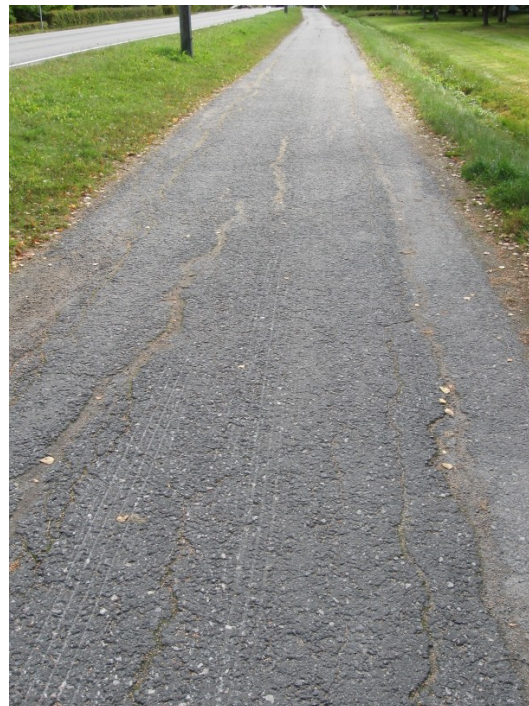
Reittikuva 23. Karkeaa ja railoontunutta asfalttia Ritopohjantiellä.
