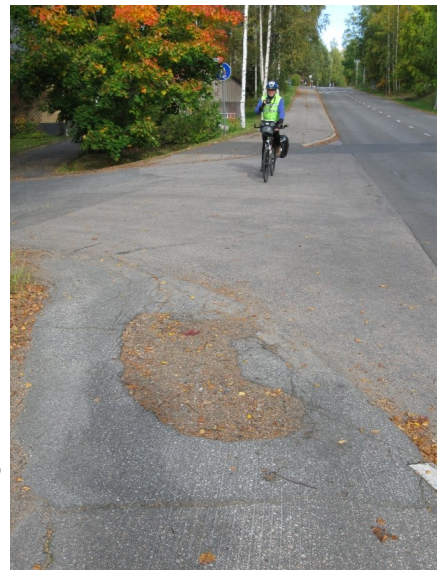
Reittikuva 18. Ukonniementiellä väylä on osan matkaa turhan kapea. Asfaltissa on myös muutamia pahoja vaurioita.
