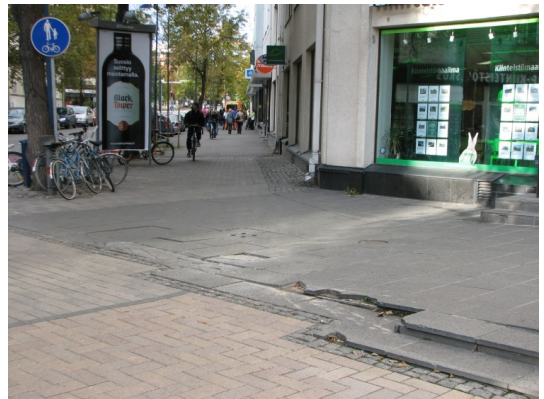
Reittikuva 2. Kuva lähtöpisteestä Kalevankadun suuntaan. Huomaa vaurioituneet rappuset ja laatat.
