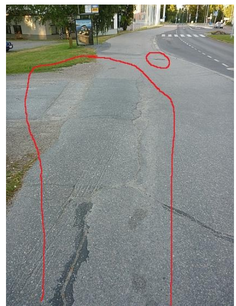
Reittikuva 20. Kuva Liikunnan rakennuksen edustalta. Asfaltti on epätasaista ja parkkipaikan liittymästä tulee väylälle hiekkaa. Taustalla erottuu myös yksi montulla oleva kaivonkansi.
