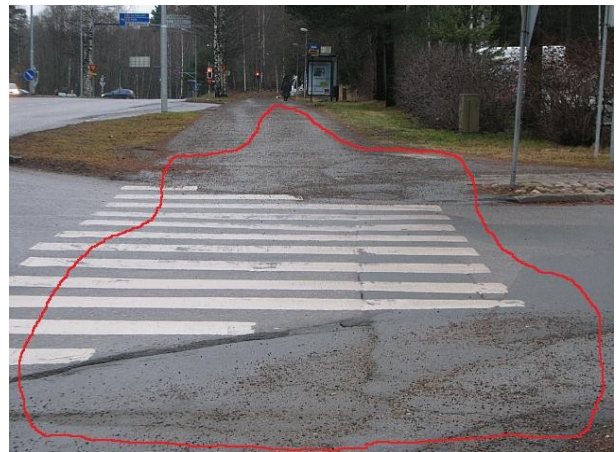
Reittikuva 31. Kyllön terveysaseman liittymässä asfaltti on epätasaista. Liittymän jälkeen asfaltissa on muutama vaarallinen railo.
