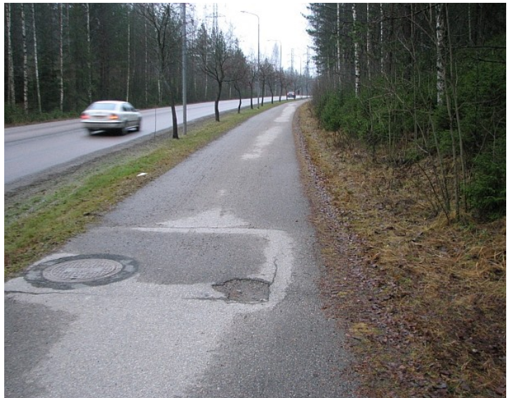
Reittikuva 82. Osuuden puolivälissä on noin 30-senttinen reikä asfaltissa. Vieressä on myös kaivonkansi, mutta se on asetettu harvinaisen tasaisesti. Väylän metsänpuoleista reunaa voisi hieman siistiä.
