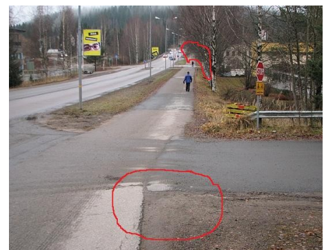
Reittikuva 39. Teollisuusalueen liittymän kulmauksesta puuttuu asfalttia. Ympäristö ei muutenkaan ole kaikkein viehättävin.
