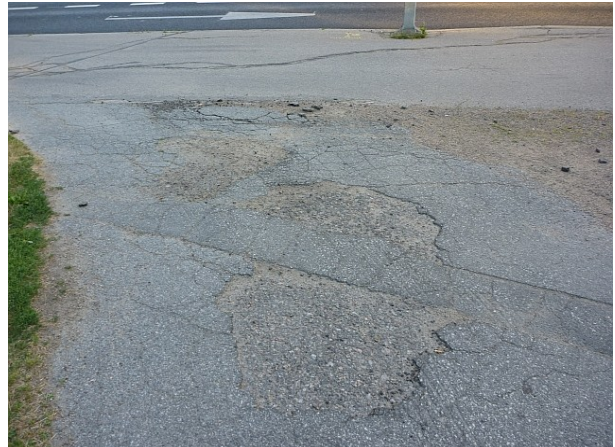
Pinta- ja rakennevaurioita Keskussairaalantien ja Pitkädun kevytväylän risteyksessä.
