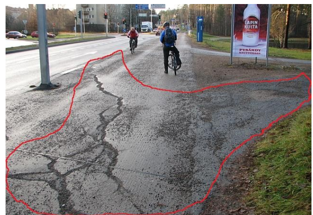
Reittikuva 23. Pitkädun kärjen ja Keskussairaalantien kevytväyläliittymä on muotoiltu kerrassaan oivallisesti. Asfaltti tosin pitäisi uusia välittömästi.
