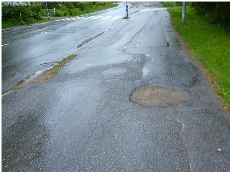
Reittikuva 74. Kahakadun ja Varpukadun välillä asfaltti on todella huonokuntoista ja pohjarakennekin kupruilee. Kaivonkansista varsinkin oikeanpuoleinen on vaarallisesti montulla.
