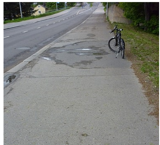
Reittikuva 27. Asfaltti Rautpohjankadun risteyksestä eteenpäin on pääosin karheaa ja kulunutta. Kuvan puolivälissä erottuu noin 10-metrinen epätasaisen paikkauksen alue.
