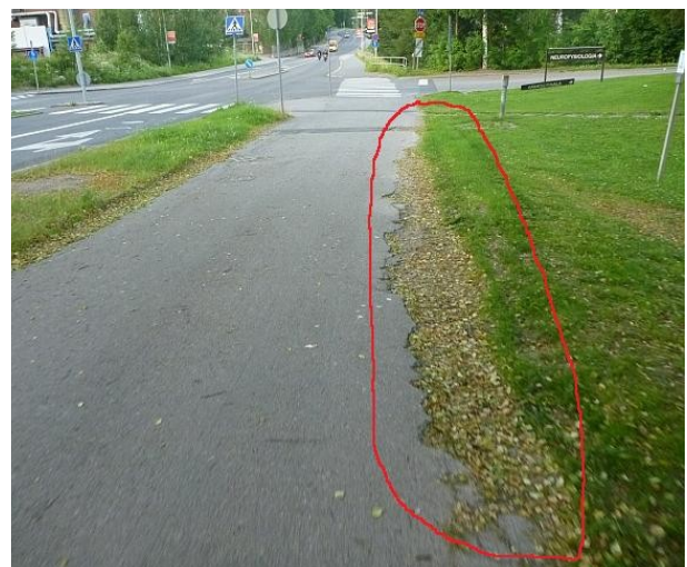
Reittikuva 33. Sädesairaalan ja Hoitajantien välillä kevytväylän reunasta puuttuu asfalttia noin 15 metrin matkalta.
