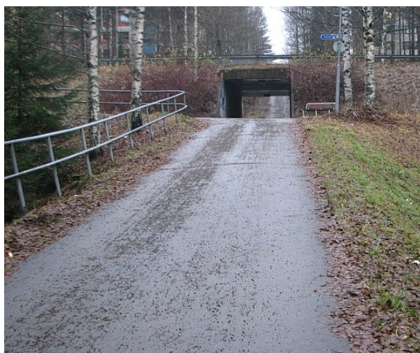
Reittikuva 48. Osuus päättyy Keltinmäentien alittavan tunnelin luo. Tunnelin edustalla asfaltti on epätasaista.
