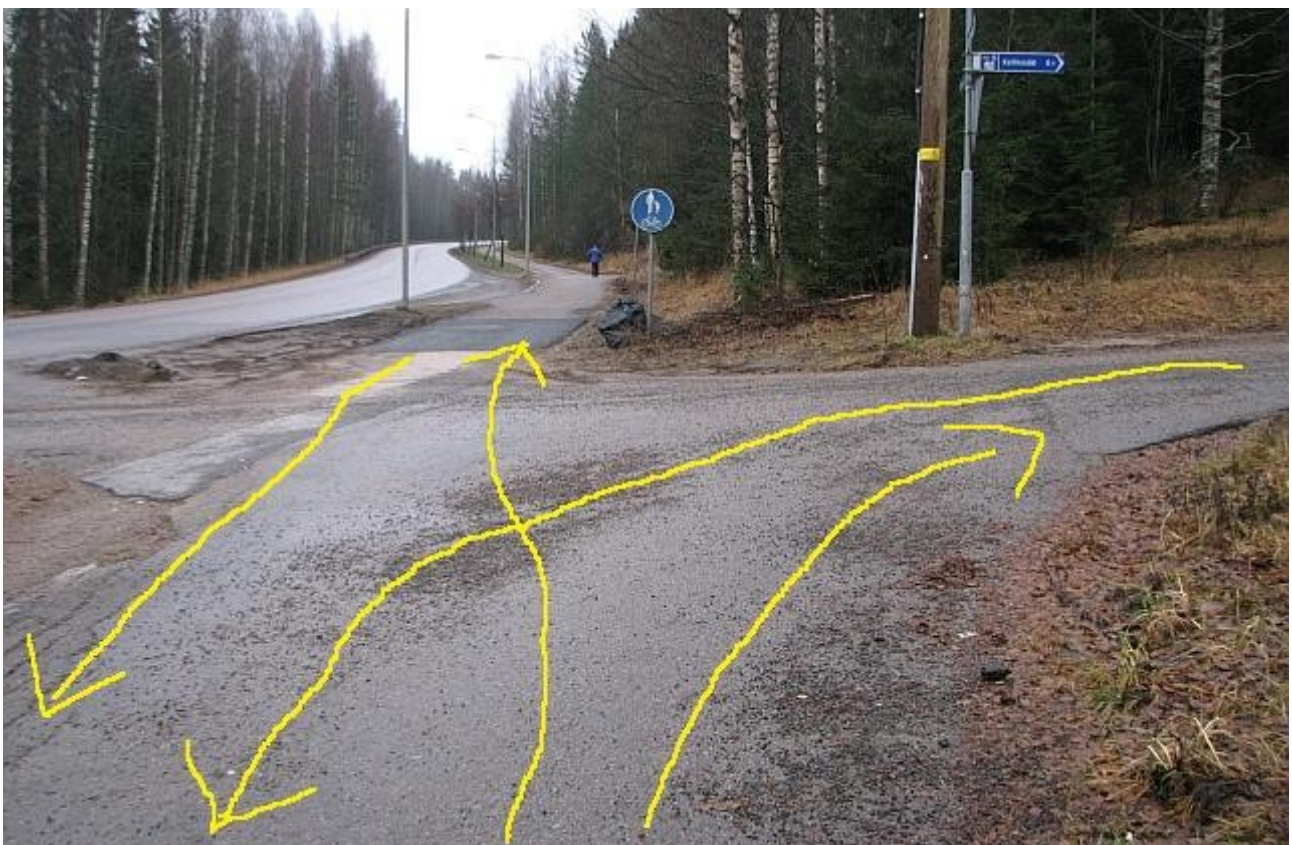
Reittikuva 42. Länsiväylän, Jussinparran ja Ronsuntaipaleentien risteys rospuuttoaikaan: risteyksessä on hiekkaa ja lehtiä. Vasemmasta reunasta puuttuu asfalttia. Keskeisimmät pyöräilylinjat on merkitty keltaisella.
