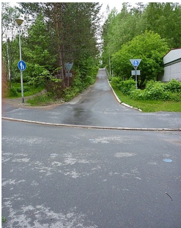
Reittikuva 58. Kotasenpolku jatkuu Vahverontien yli. Risteyksessä on jyrkkä betoninen reunatuki, joka haittaa pyöräilyä. Risteyksestä varoittavat kolmiot näkyvät kesäaikaan vain väärään suuntaan.
