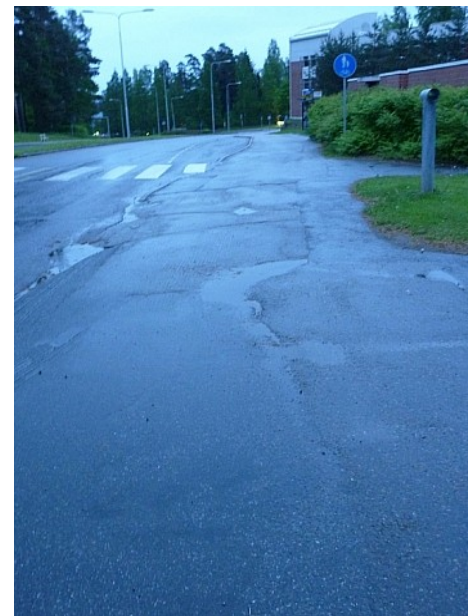
Reittikuva 36. Asfaltti keskussairaalan ja Kyllön terveysaseman välillä on epätasaista ja paikkailtua.
