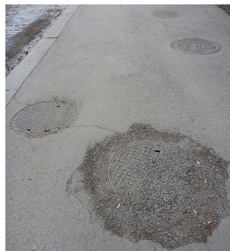
Reittikuva 17. Seminaarinkadun kevytväylällä on yksi vaarallinen montussa oleva kaivonkansi.
