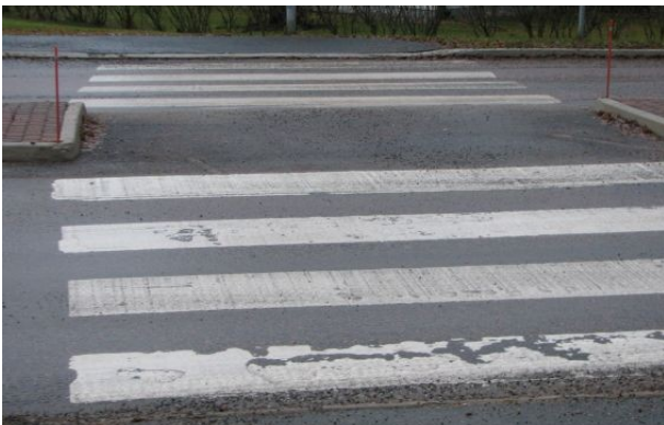
Yhdysliittymä laatukäytävällä Mäyrämäessä: 20 metrin matkalla on kolme terävää reunatukea – yksi näistä on niin jyrkkä, että sen yli pääsee vain lukkopoljinten ja maastopyörän kanssa.
