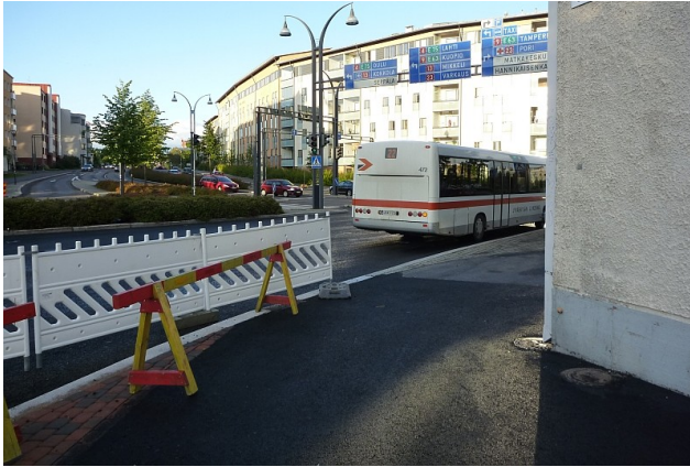
Näkemäongelma kiinteistön vuoksi Vapaudenkadun ja Kalevankadun kulmauksessa.
