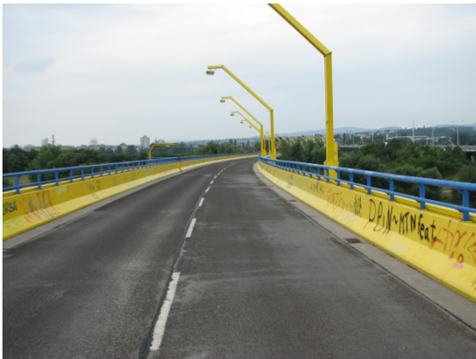
Kuva 37: Vanha autosilta on käynyt alimittaiseksi ja otettu pyöräilykäyttöön.
