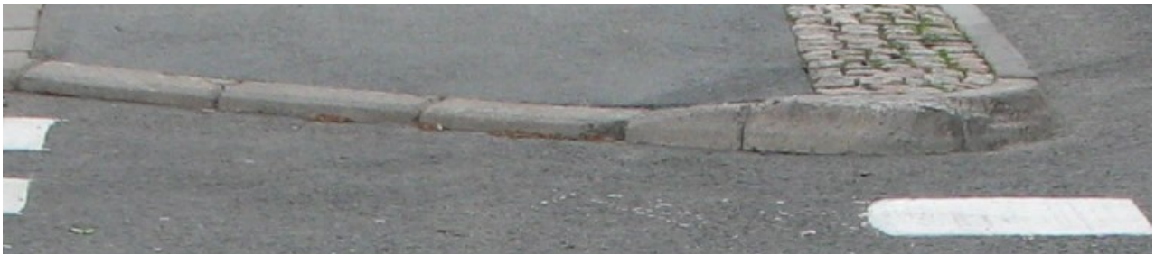
Tämä betonireunus on jo selvästi vaarallinen.
