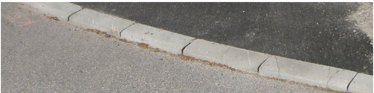
Säännöllisesti toistuessaan tällainen betonireunus hankaloittaa merkittävästi pyöräilyä ja estää lastien kanssa ajamisen.
