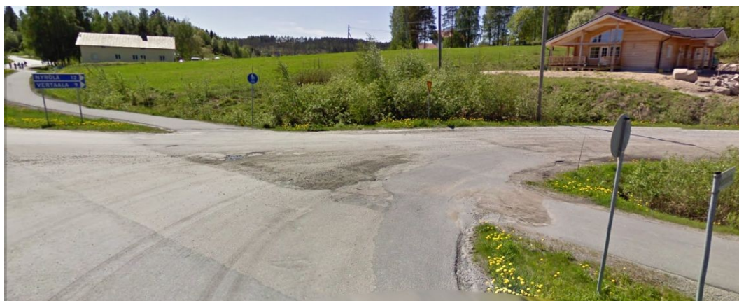
Kuva 1. Kennäntieltä valuu Puuppolantien kevytväylälle runsaasti hiekkaa ja soraa. Asfaltissa on pahoja vaurioita. Kaikki lausunnon kuvat on toteutettu Google Street View -näkyvän pohjalle.
