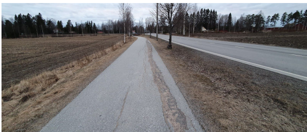
Jyväskylätien ja Seppäläntien välillä nykyinen yhdistetty jalkakäytävä ja pyörätie on huonokuntoinen sekä kyseiseen paikkaan liian kapea.
